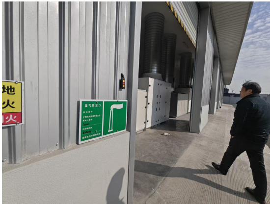
1#废气处理设施
