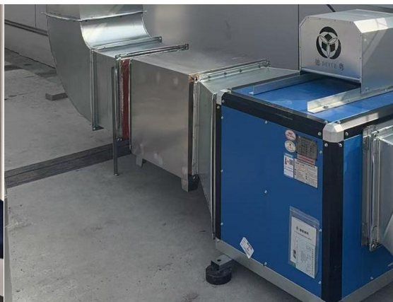
3#废气处理设施
