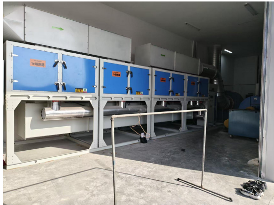
2-1#废气处理设施
