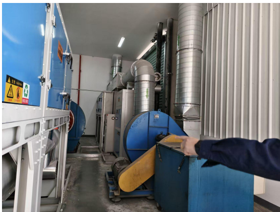
2-2#废气处理设施
